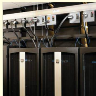
Busway Track, da Starline, fornecido no Brasil pela TC Solutions: simplifica a troca e manutenção de servidores em data centers
